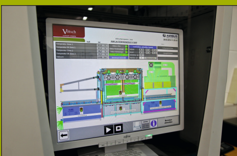
Steuerung - PC mit Siemens S7 Visualisierung
